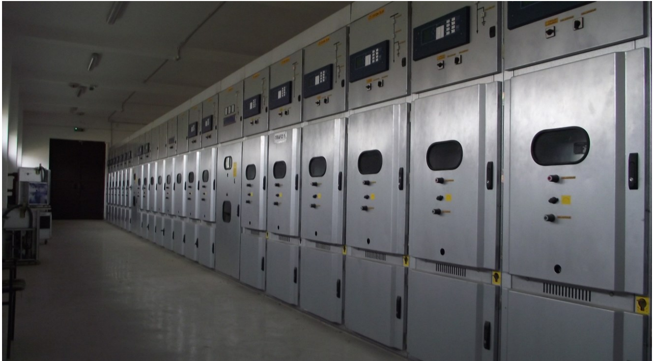
Sl.1 Postrojenje 20 kV TS 110/20/10 kV/kV/kV Jagodina 3
